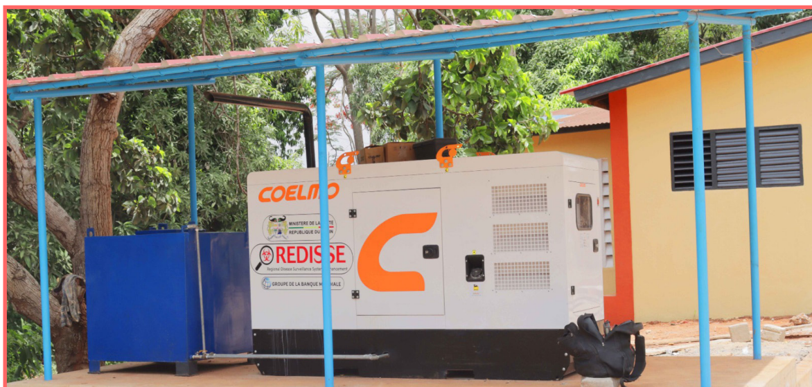
Groupe électrogène installé dans les hôpitaux
